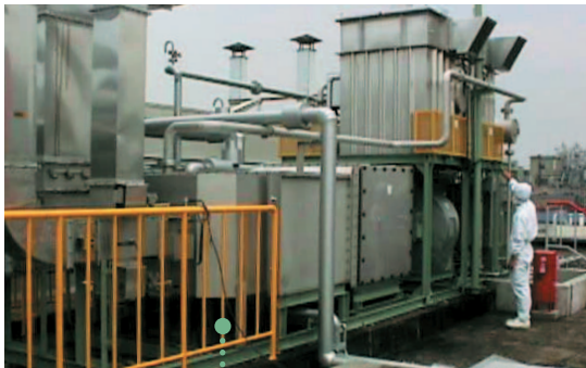
化学物質の排出削減対策 (溶剤回収装置)
